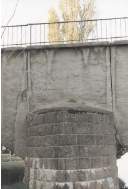
Bild 2.4: Zustand Pfeiler 1, Seite Alsleben mit Kämpfergelenken Überbau 1 und 2
