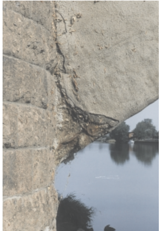
Bild 2.5: Wasseraustritt Kämpfergelenk Pfeiler 1
