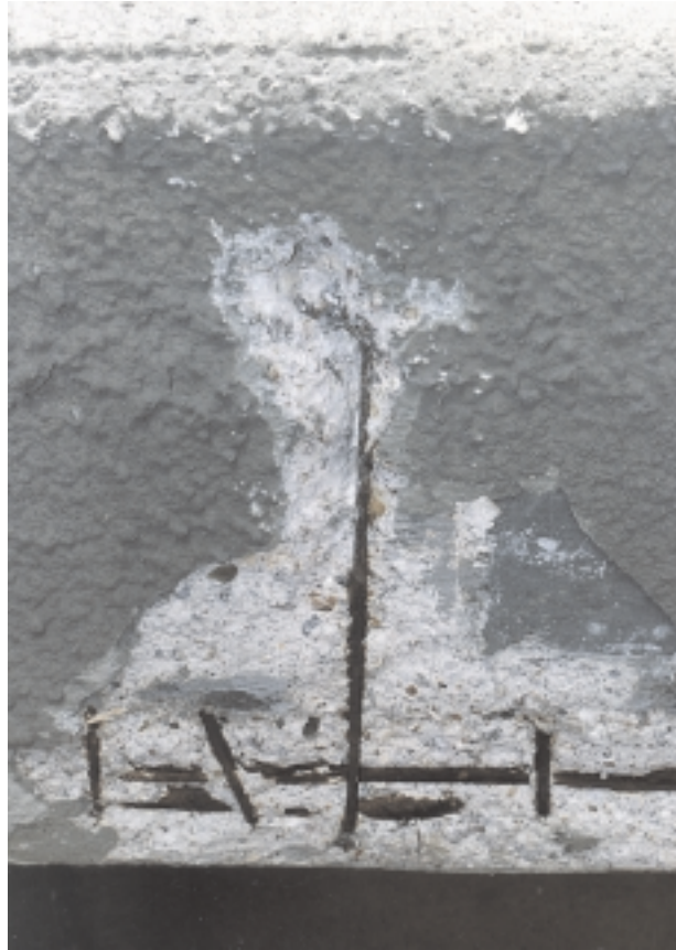
Bild 2.6: Korrodierte Bewehrung, Stromüberbau, Unterseite Hauptträger
