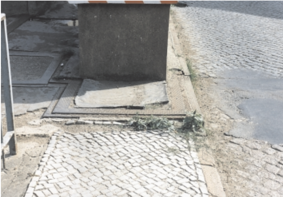
Bild 2.9: Strompfeiler Seite Alsleben: Schäden am Fahrbahn- und Gehweg
